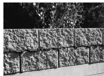
4. Vytlačovanou maltu odstraníme až po mírném zavadnutí, zabrání se tak možnému znečištění tvárníc.
